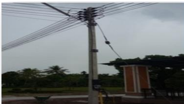
ภาพที่ 3.16 เสาไฟฟ้าแรงสูงภายในโครงการ
