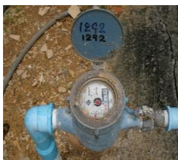
ภาพที่ 3.41 แหล่งน้ำประปาที่นำมาใช้ในโครงการ
