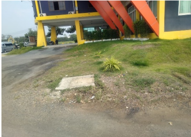
ภาพที่ 3.19 ระบบระบายน้ำ
