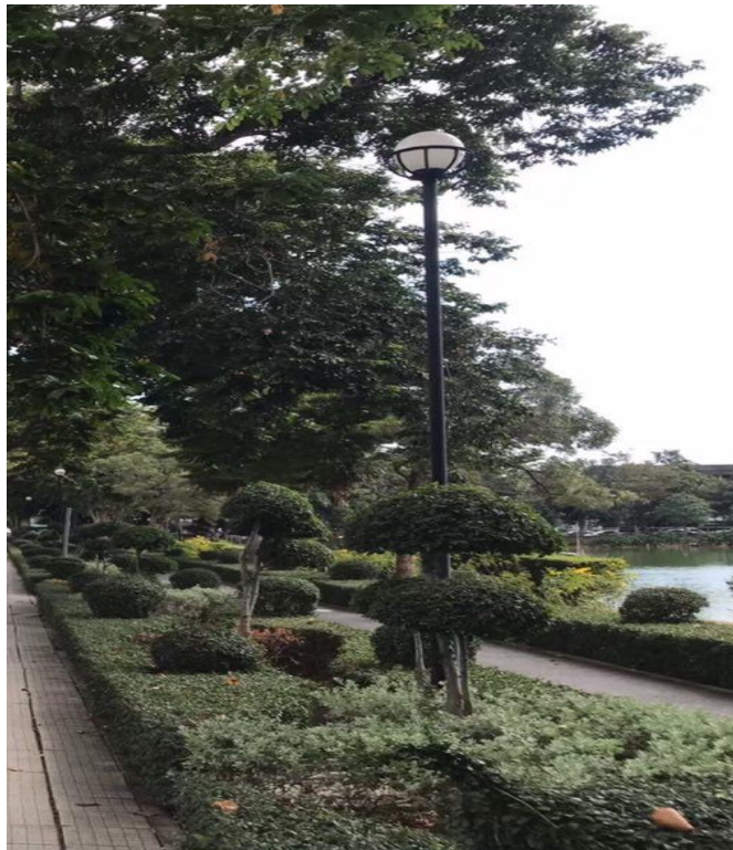
ภาพที่ 3.14 ระบบไฟฟ้า
