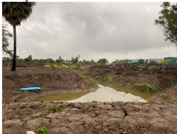
ภาพที่ 3.15 ระบบระบายน้ำเข้าและออกภายในโครงการ
