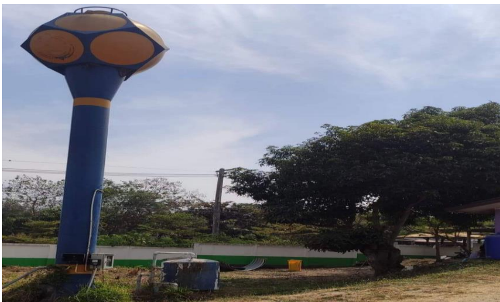
ภาพที่ 3.23 ระบบประปา
