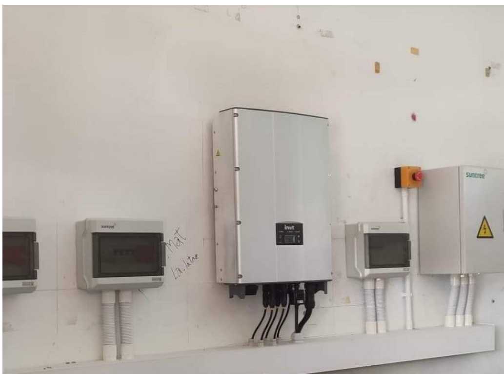
ภาพที่ 3.22 ระบบไฟฟ้า
